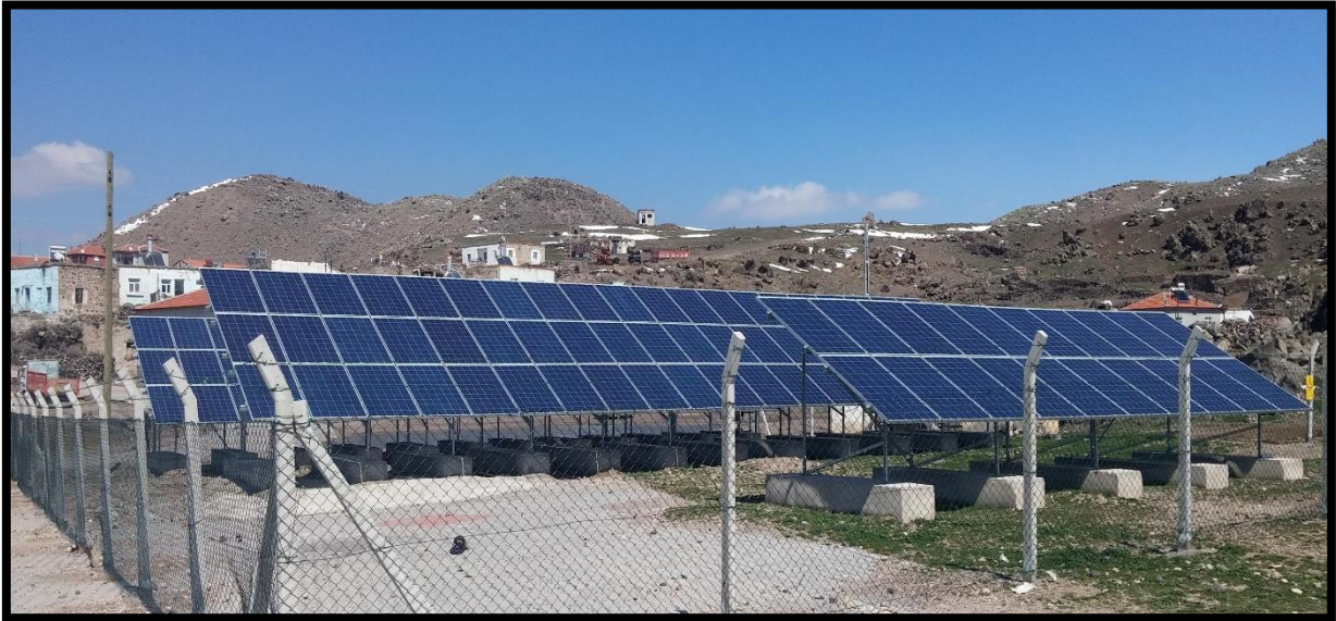
Güneş Enerjili Dalgıç Pompa Sistemi Uygulama Projesi (7 Köy) (Aksaray)
