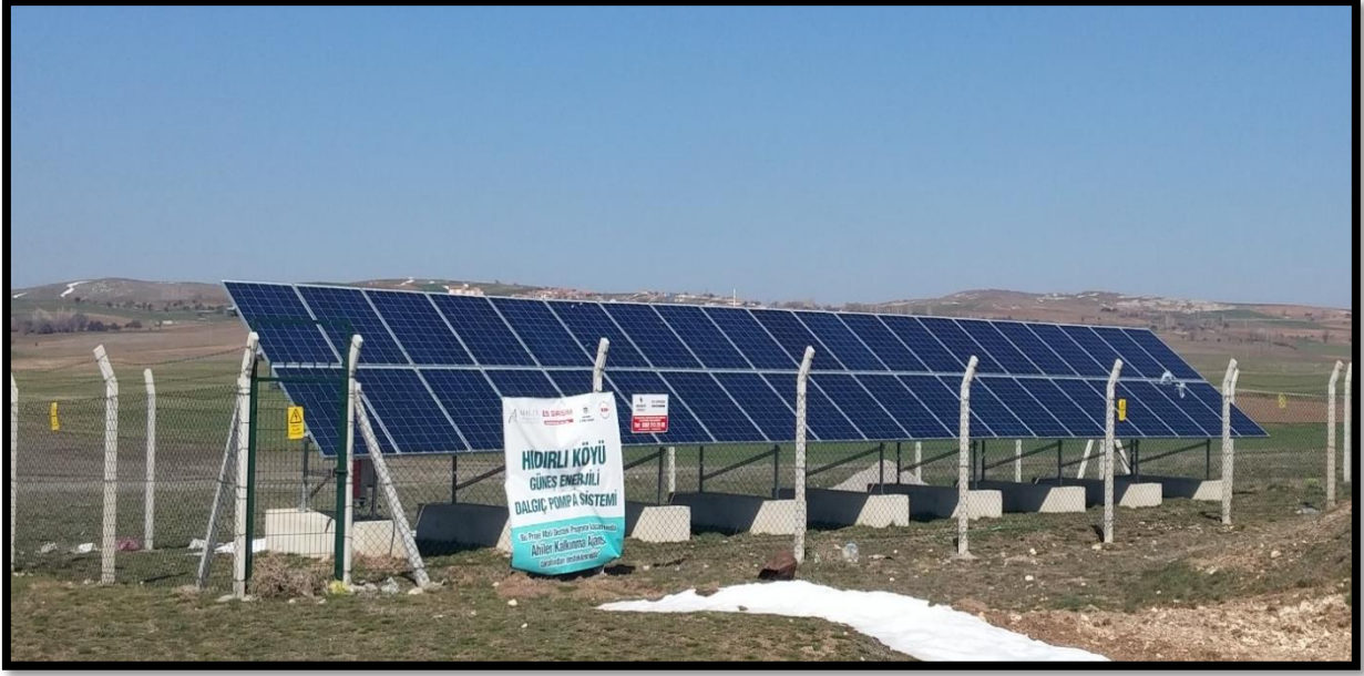
Güneş Enerjili Dalgıç Pompa Sistemi Uygulama Projesi (7 Köy) (Aksaray)
