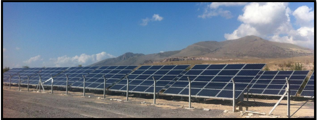
26 Köyün İçme Suyu Pompa Enerji İhtiyacının Güneş Enerjisi ile Karşılanması Projesi (Niğde)
