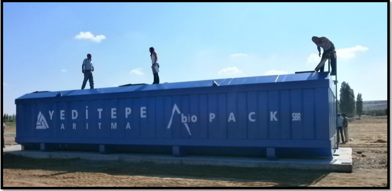
Boğazköy Kanalizasyon Biyolojik Arıtma Tesisi Projesi (Nevşehir)
