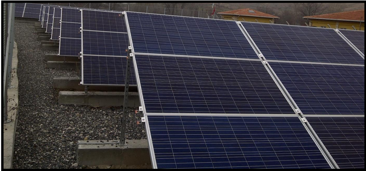
Atık Su Arıtma Tesisinde Güneş Pillerinden Elektrik Üretimi Projesi (Nevşehir)
