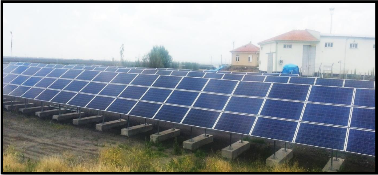
Güneş Enerjisinden Elektrik Üretimi Projesi (Aksaray)
