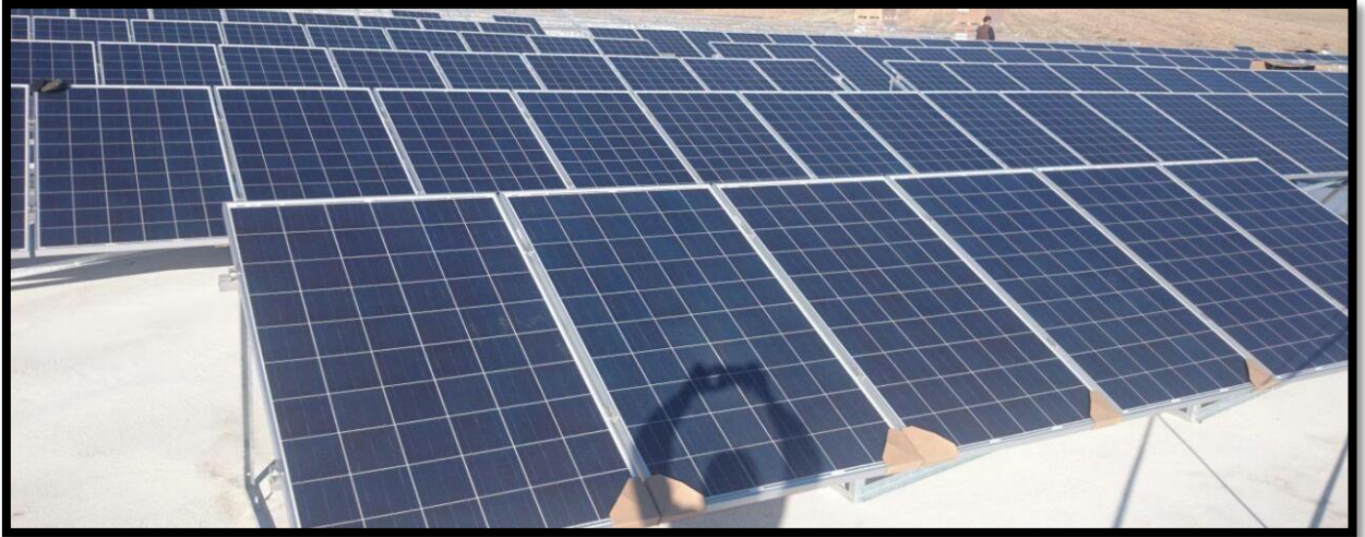
Pv-Fotovoltaik Elektrik Üretim Tesisi Projesi (Kırşehir)
