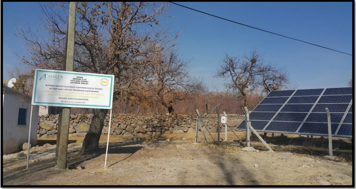
26 Köyün İçme Suyu Pompalarının Elektrik Enerjisi İhtiyaçlarının Güneş Enerjisiyle Karşlanması Projesi (Niğde)
