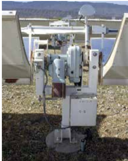
Şekil 2.22. İzleme Sisteminin Elektrik Motor – Şanzıman Kısmı
