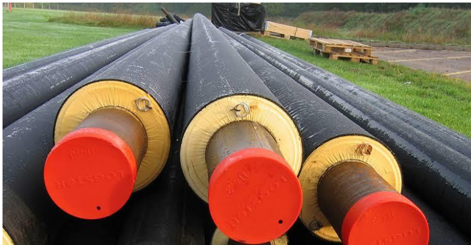
Fotoğraf 22 Ön izolasyonlu Boruların Üzerindeki Kaçak İzleme Kabloları
