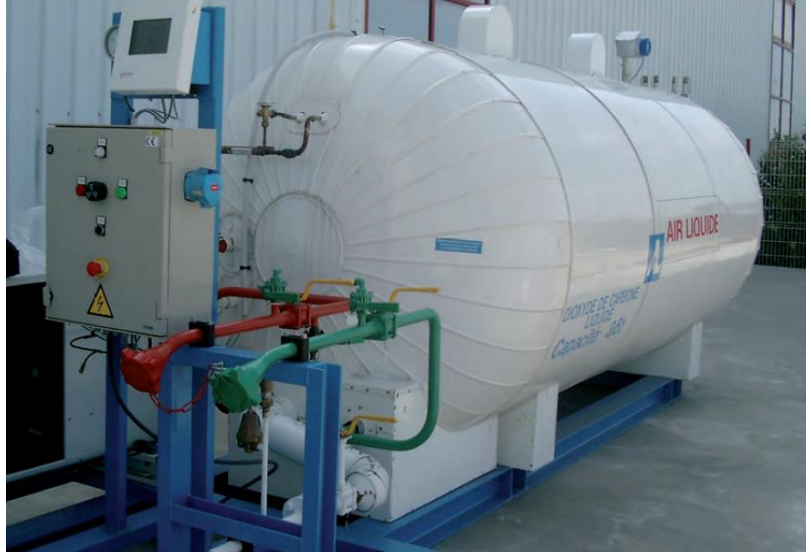
Şekil 1.2. Hava Beslemesi & CO2 Depolama Tankı
