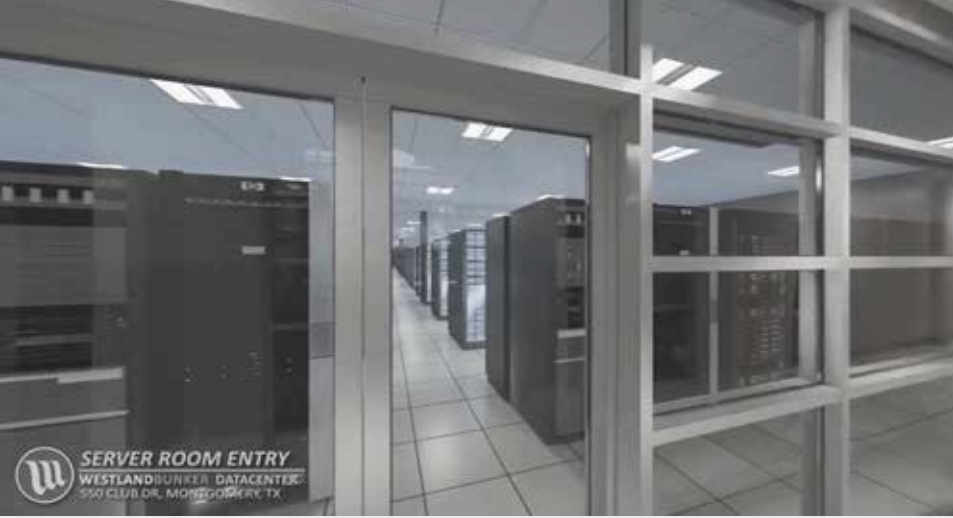
Görsel Kaynak: Data Centre Magazine. (n.d.). Top 10 underground data centres.
